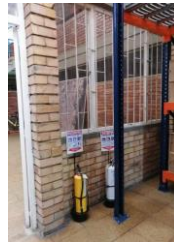
Fotografía 10 Extintor ABC multipropósito y Solkaflam, con instalación y señalización
